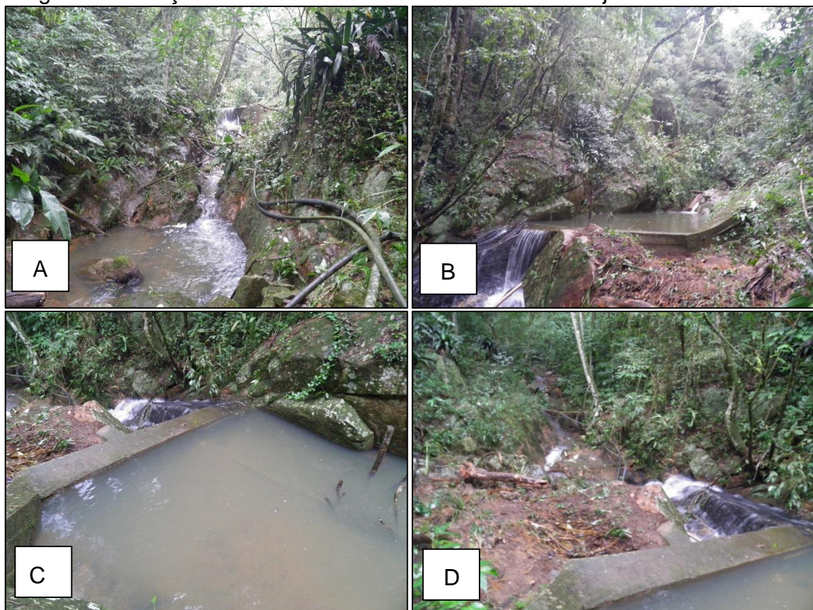
Figura 28 - A, B, C) Manancial que abastece a Comunidade de Laranjeiras; D) Barragem e tubulação do manancial da comunidade de Laranjeiras.
