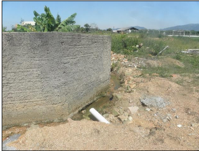
Figura 84 - Rede de esgoto predial sem tratamento com lançamento direto na drenagem, Cano de PVC próximo a E.E.B Domingos. B. Cabral.
