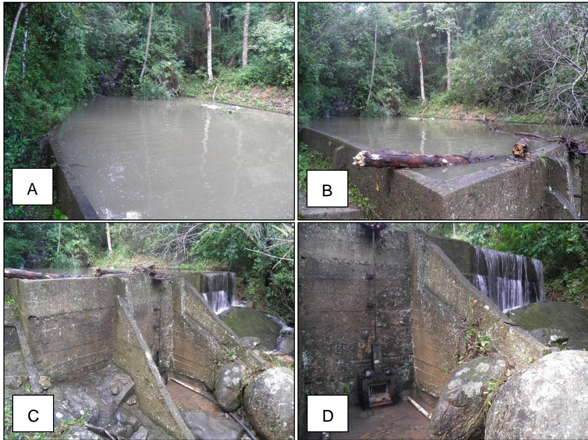
Figura 26- A) e B) Manancial de Captação da Comunidade do Km 37, C) Barragem do Manancial superficial, D) Tubulação por onde a água é distribuída a comunidade do Km 37
